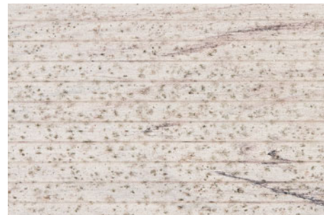
Stockflecken/Schimmel auf der Oberfläche
